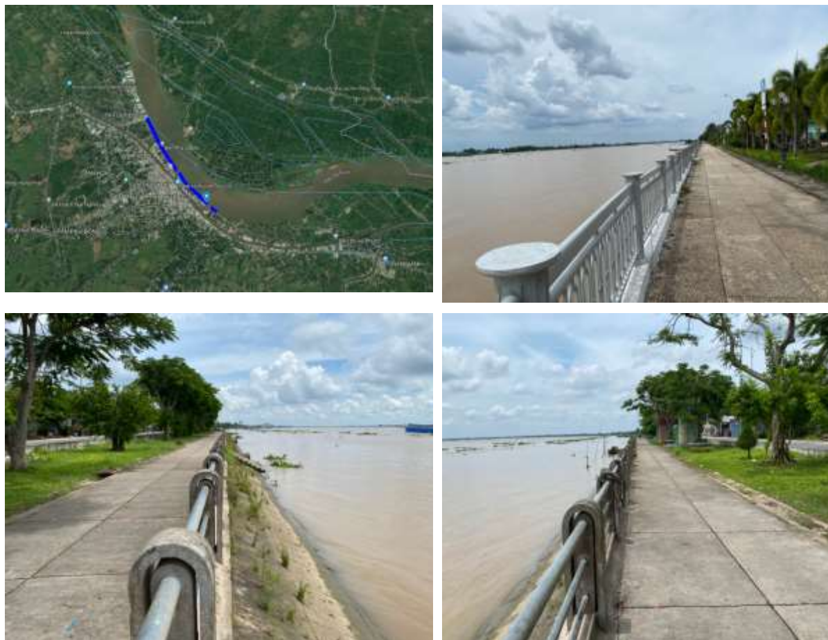
Hình 3-5. Kè bảo vệ bờ sông Tiền khu vực Tp Sa Đéc
