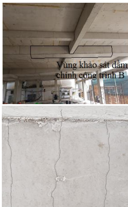
Hình 5: Khảo sát công trình B Đầm có xuất hiện vết nứt
