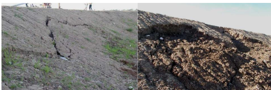
Hình 1: Mái đê bị nứt và sạt trượt
