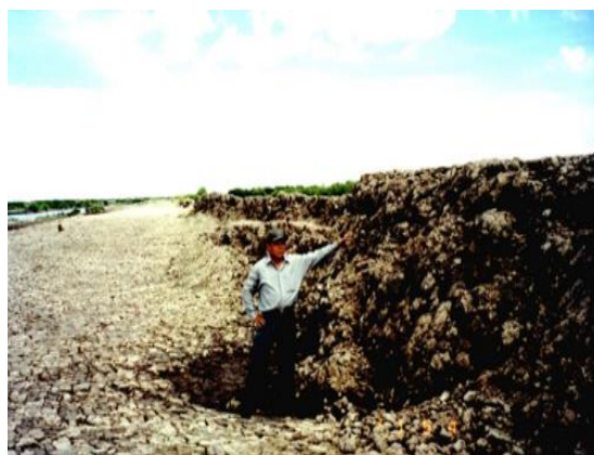
Hình 2: Đê biển Cà Mau bị sụt lún do đất chưa kịp cố kết
