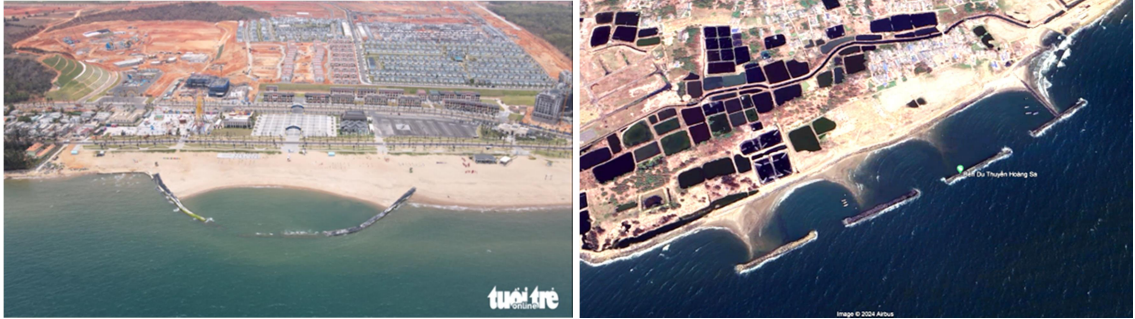
Hình 6. Kè lấn biển vùng bờ biển tỉnh Bình Thuận (nguồn: Báo Tuổi trẻ)
