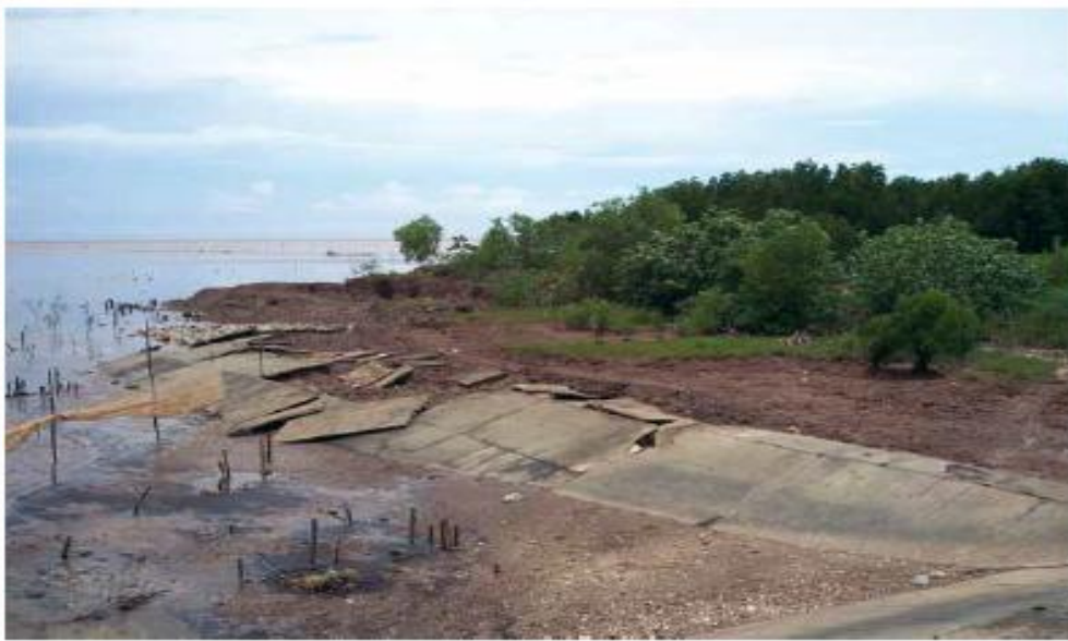
Kè bị hư hại
