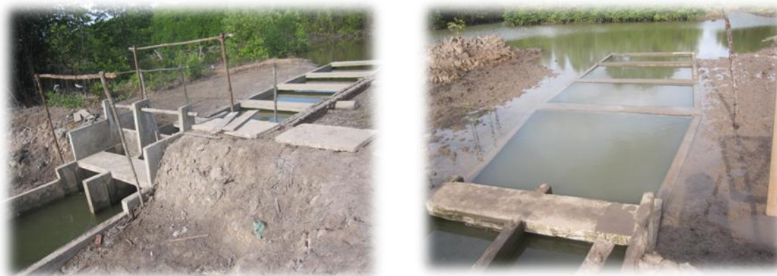
Hình 40. Cống cấp, thoát nước vùng nuôi tôm rừng
