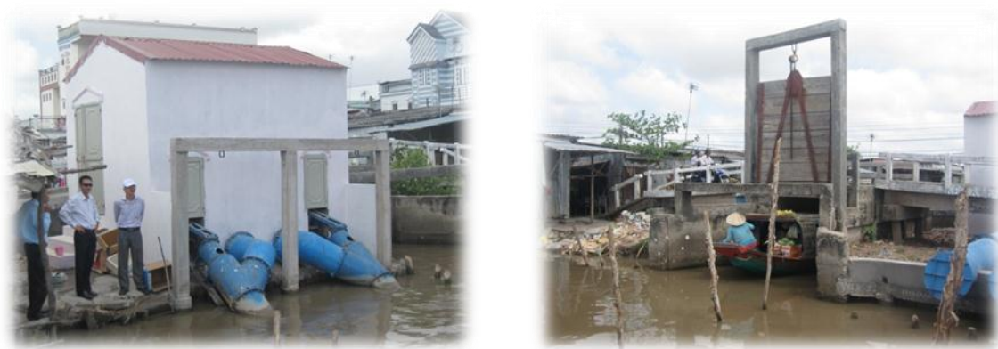
Hình 43. Công tiêu kết hợp trạm bơm tiêu trực xiên (Cà Mau)
