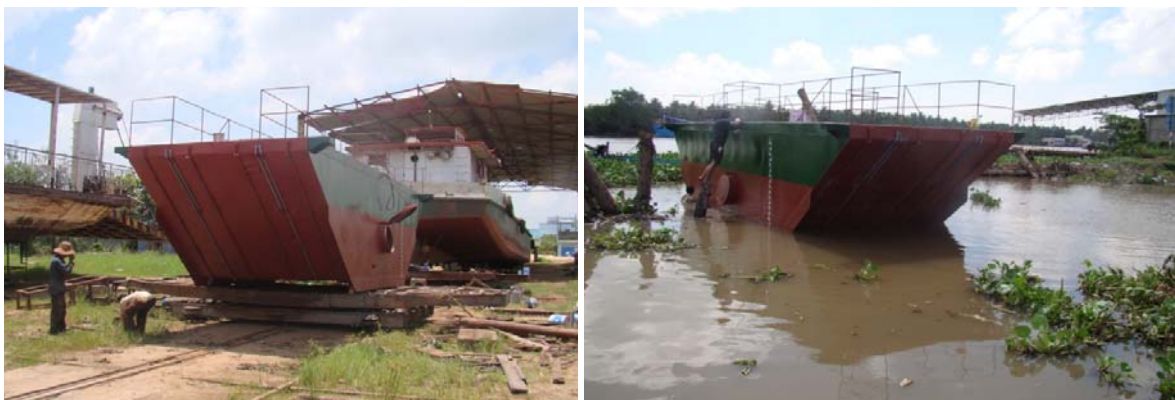
Hình 4: Gia công mô hình đập thời vụ di động tại nhà xưởng và lai dắt
